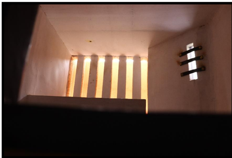
Figura 67 - Frestas do fundo da cela tampadas
