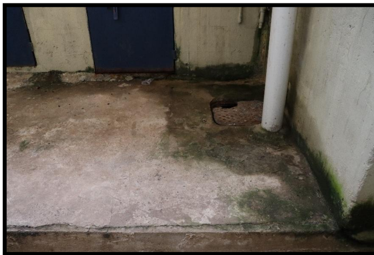
Figura 30 - Mofo e infiltração na ala PCD
