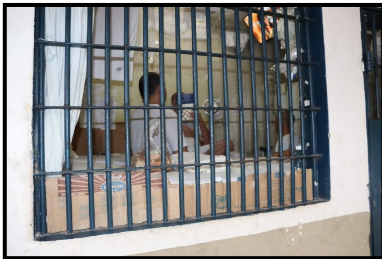
Figura 26 - Abertura lateral da cela da ala PCD com papelão tampando a grade embaixo
