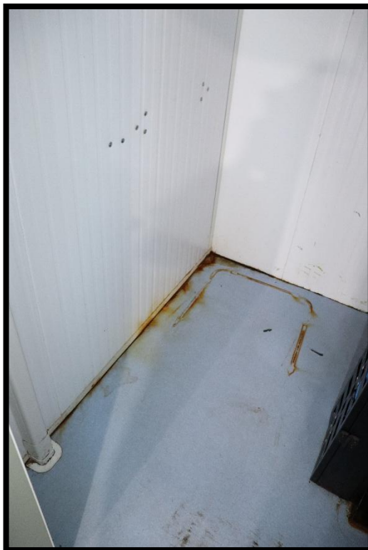
Figura 49 - Infiltração e afundamento de piso da UBS
