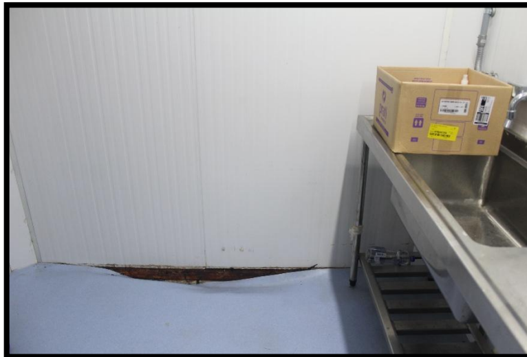
Figura 48 - Afundamento do piso da UBS
