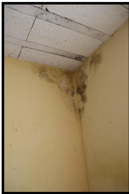
Infiltração no quarto. Fonte: Acervo MNPCT, 2024.
